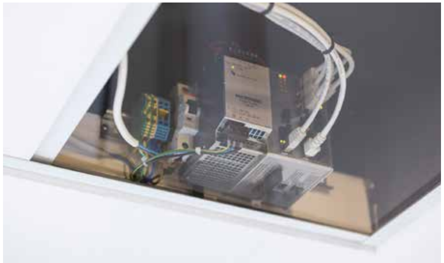
MICROSENS Smart Engine übernimmt die Energieversorgung der Leuchten
