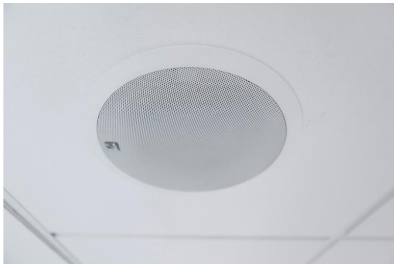
Abb. 12: Audiosystem – integriert in einer Rasterdecke
